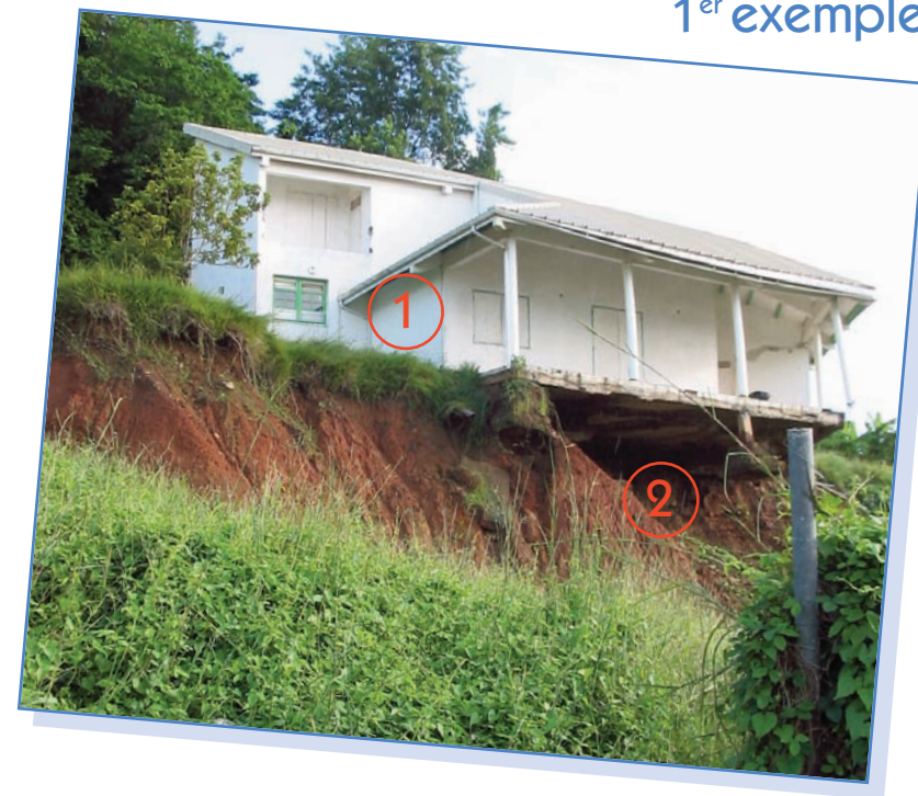
Exemple d'un glissement de terrain
